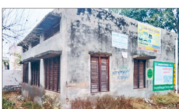
बाढ़ड़ा। गांव हड़ौदी में जर्जर हालात में पंचायत भवन। फोटो: हरिभूमि
